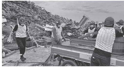
倒壊家屋から運び出され山となった廃材集積所
